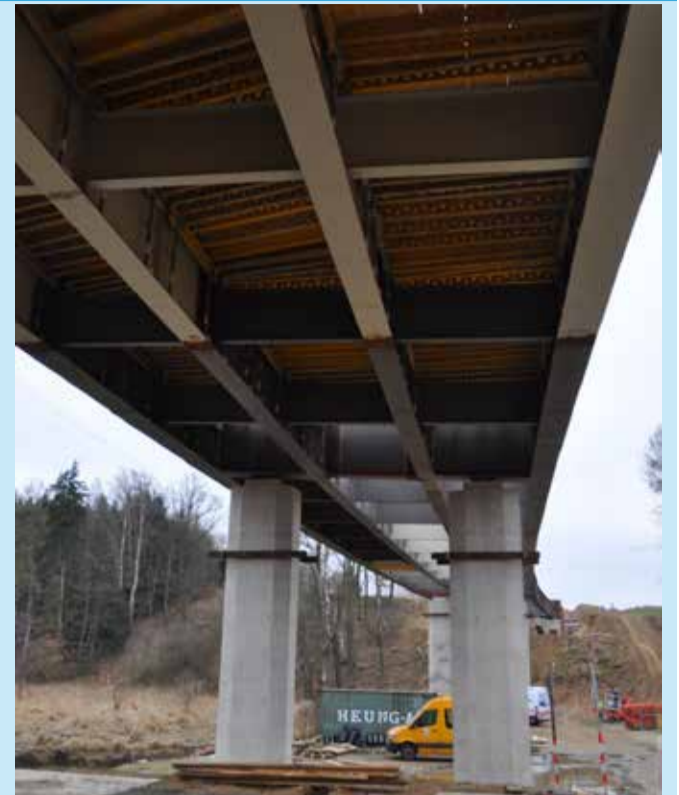
S rokem 2018 pokračuje stavební ruch na „rouštanské“ části přeložky silnice I/34 - přemostění Rouštanského potoka a místní komunikace směr Jilemník. Zřetelně vidět je nové bednění přilehlého pole mostu, na řadu přijdou armatury a nakonec betonáž. Ta - jak věří stavbyvedoucí Metelka - vyvrcholí v únoru. JKt
