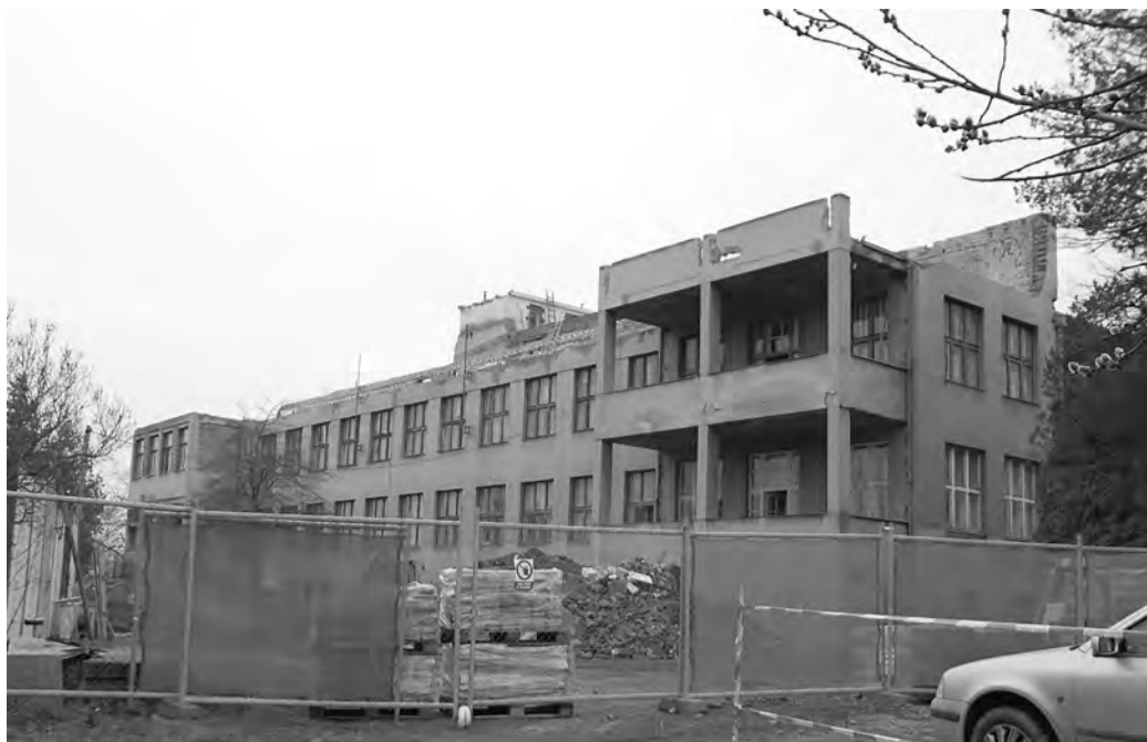
Nezvyklý pohled na bývalou ortopedii bez střechy a nevyhovujícího nejvyššího patra. To musí být postaveno znovu.
